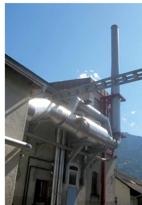
Der Abgaswärmetauscher des Dampfkessels liefert bis zu 800 kW ins Fernwärmenetz.
