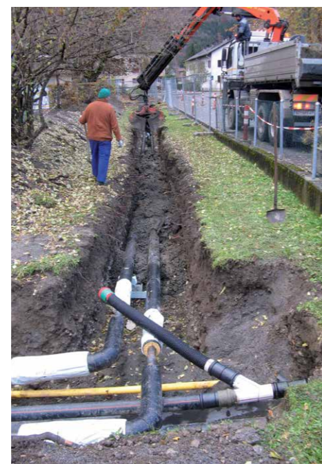
Über eine rund 900 Meter lange Leitungstrasse werden die externen Abnehmer mit Fernwärme versorgt.
